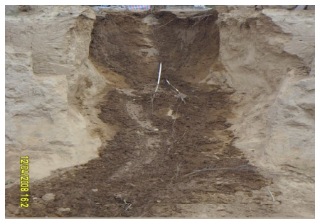
图 7 滑塌后的边坡
